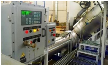
Трубопоршневая поверочная установка
